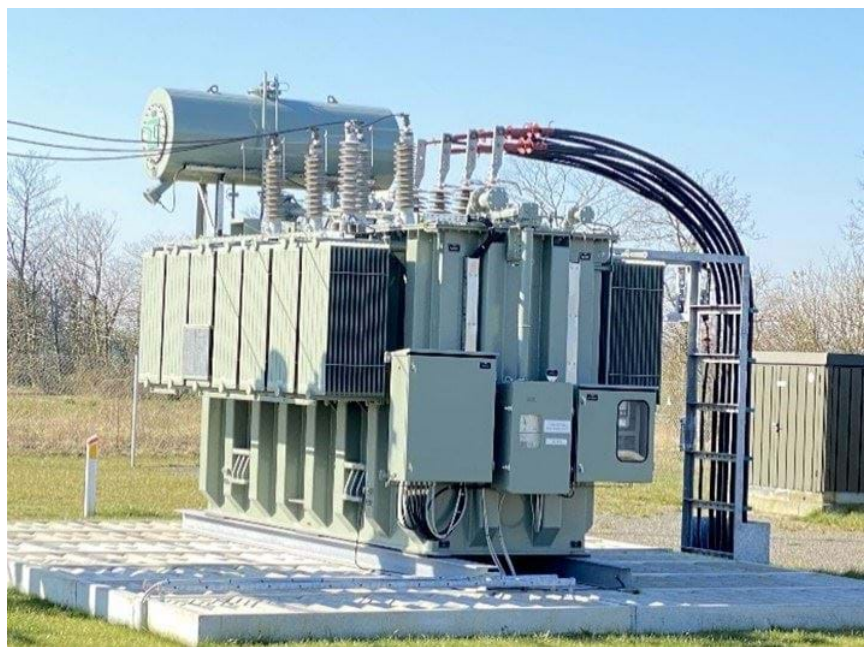
Figur 9. Eksempel på Stationshus og Forsyningstransformer
